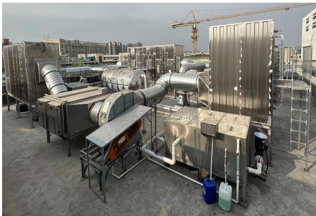
喷涂烘干废气净化治理设施
